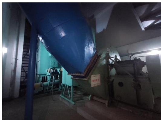
停炉检修时的除臭设备
